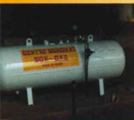
Matériel de mise en oeuvre du biogaz
